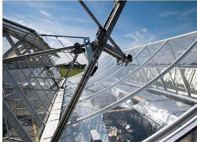
De dakconstructie van de Elkas in aanbouw. Het gebogen glas laat het zichtbare licht door maar reflecteert de zonnewarmte naar zonnepanelen. Foto: Leo van Velzen
