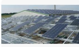
solargreenhousesystems.nl Zonne-energie voor de tuinbouw | Solar ...
