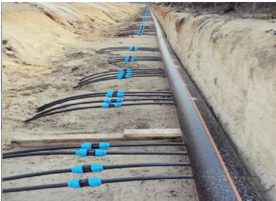
Figuur 2. Slangenbuffer en distributieleiding (Foto Cogas Zuid).
