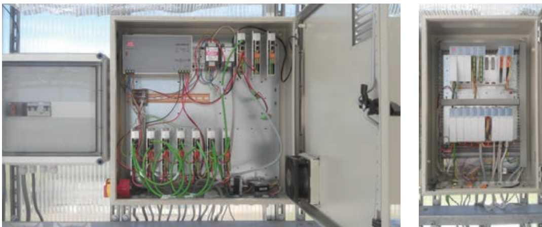
Figuur 41. Hardware voor het meten en aansturen van de lamellen, gemonteerd in de Elkas
