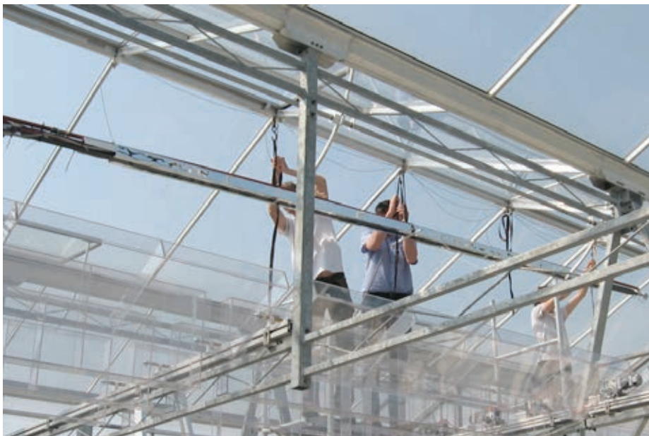
Figuur 51. Installatie van de CPV-module in de Elkas. Door middel van spanbanden wordt de CPV-module richting de onderkant van de nok getrokken.
