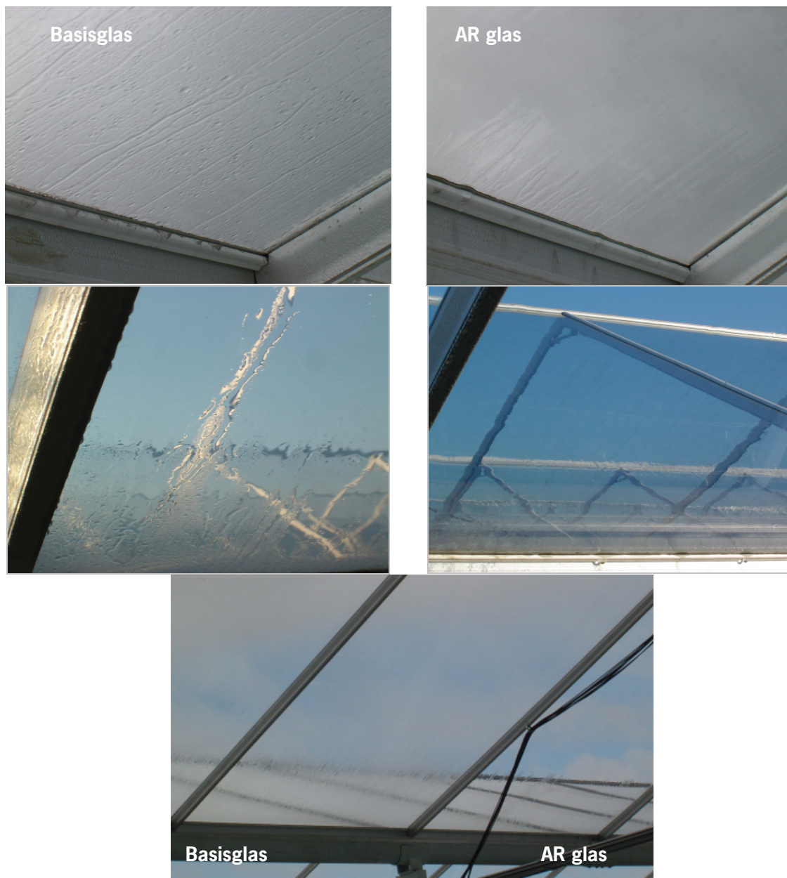
Figuur 33. Verschil in condensatiegedrag in de praktijkkas, links het basisglas en rechts het AR glas, opnames gemaakt op 31 maart en 28 juni 2006.
