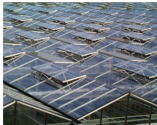
Natuurlijke ventilatie via dakramen
