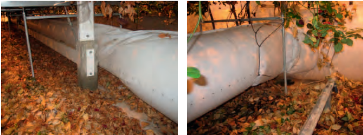
Figuur 2.12. Niet strak hangende luchtslangen.
