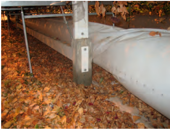
Figuur 2.22. Slang 1 hangt tegen de spantpoot.
